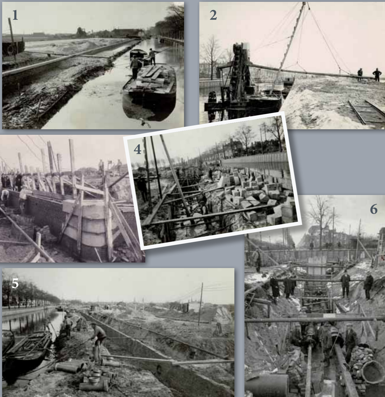
Foto 1. Aanvoer van bouw materiaal, 2: baggeren, 3: werk aan de brug t.h.v. Loosduinse vaart, 4 en 5: verbreding van de vaart richting Loosduinen en richting Den Haag, 6: aanleg van zinkers dwars door de Loosduinse Vaart, met links vooraan Arie en Jan den Ouden, met gleufhoed. Aan het eind is de betonnen beschoeiing zichtbaar ter vervanging van de bakstenen kademuren om de grotere waterdruk beter op te vangen. Aan de overkant van de vaart kijken mensen op de kade toe, 1926-1927.*
