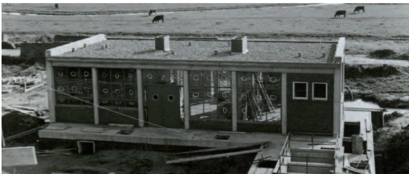
Het machinegebouw van de in aanbouw zijnde waterzuiveringsinstallatie aan De Voscuyl, september 1956.
